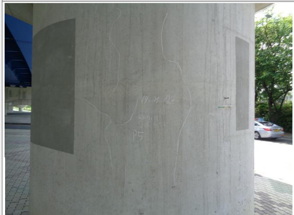
<P5> 기둥부 망상균열
